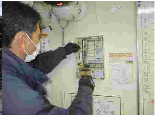
【消防設備点検(R2.12.10)】
