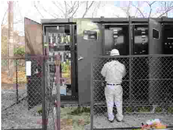
【電気設備点検 (R2.12.2)】
