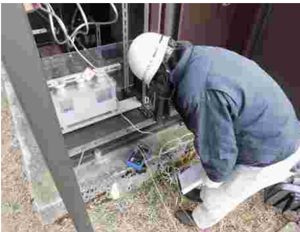
【電気設備点検 (R1.12.3)】
